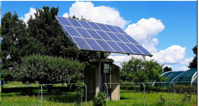
Ein Heliostat in Kolenfeld, eine hocheffektive Solaranlage, leider sehr teuer und darum rar...
